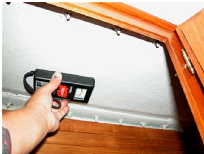
Ofta saknas taggarnering inne i skåpen, bra vid fuktmetning av sandwichlamina-tet i däck.
