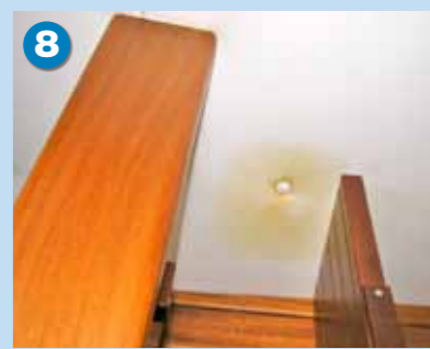
På andra ställen i båten upptäcks mer fukt rakt igenom taggarneringen och fler gula knappar; katastrofen ett faktum. Här handlar det inte bara om att byta teakdäcket, hela sandwichlamina-tet är kanske uppruttet. Vi talar om mycket stora reparationskostnader.
